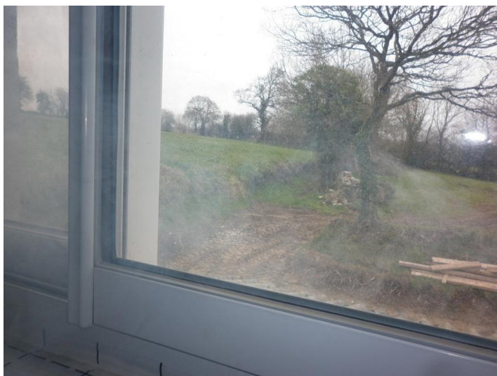
Photo : Fumée s'échappant d'une fenêtre coulissante lors du test d'étanchéité intermédiaire en surpression sur la rénovation C3 - 1 « LECRONIER »
