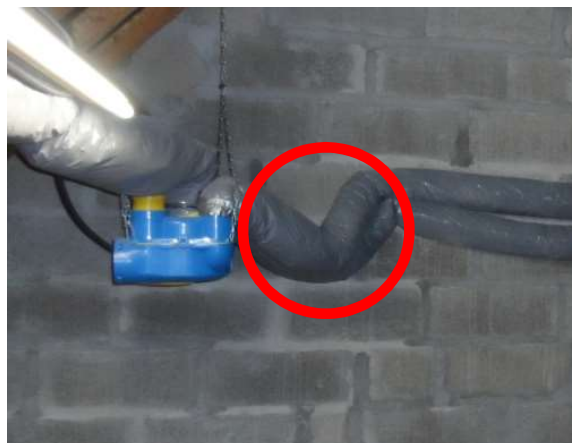
Eviter les points bas dans le réseau !
